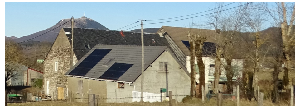
A Olmont, exemples de structures d'encadrement de même couleur que les panneaux solaires
