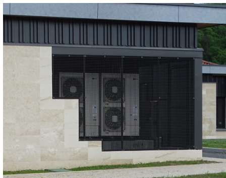
Intégration des blocs de climatisation au sein du bâtiment (St Cyprien, 24)
