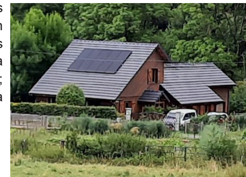
Exemple de panneaux solaires bien intégrés en toiture
