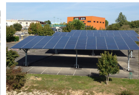
Ombrière photovoltaïque à Champniers, 16 (source : pcer.fr)
