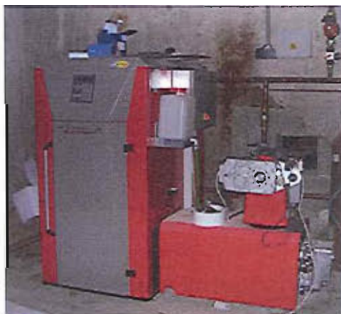
Exemple de chaudière bois
