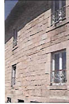
Un des rares exemples de maçonnerie de pierres taillées destinées à rester apparentes.
