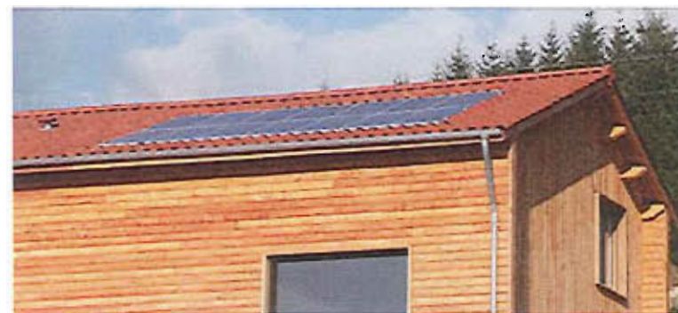
Le choix du solaire en amont du projet permet une meilleure intégration des capteurs.
