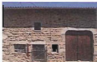
La porte d'étable et la porte de grange sont les principales ouvertures des dépendances agricoles. Le linteau peut être droit ou cintré.
