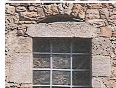
L'arc de décharge qui surplombe certaines ouvertures n'est pas un élément décoratif. Son rôle est de soulager les charges exercées sur le linteau en les repoussant sur les côtés.
