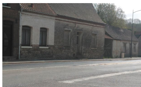
Exemple de bâtiment dégradé (Rue de Caucourt)
