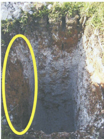
Poche d'argile conduisant à la discontinuité du substrat calcaire
