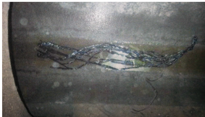
Pieuvres installées dans le réseau d'assainissement
