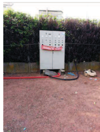
Armoire de commande provisoire
