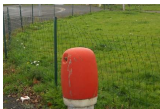
Poteau incendie situé au lotissement les Vallées
