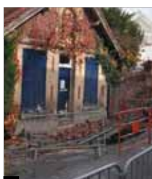
8 Effondrement du sol par la présence de galeries souterraines.
