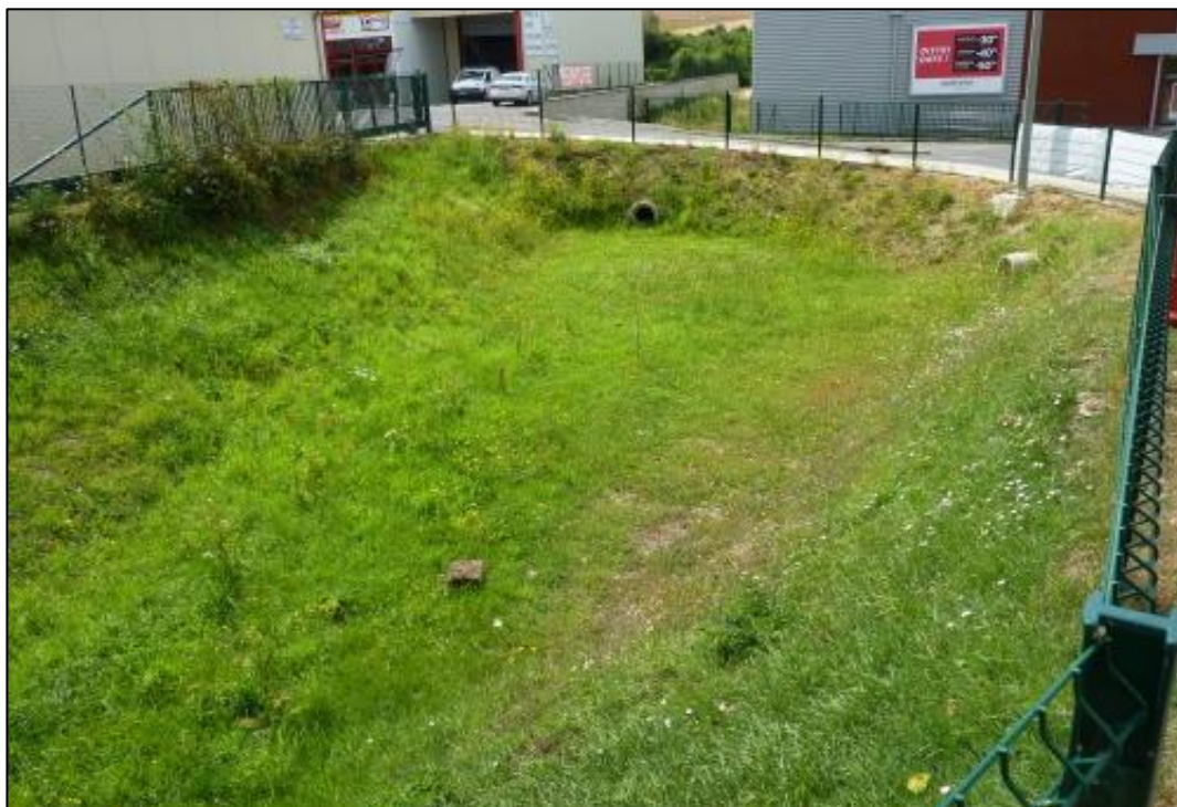
Figure 55. Photo du bassin 8
