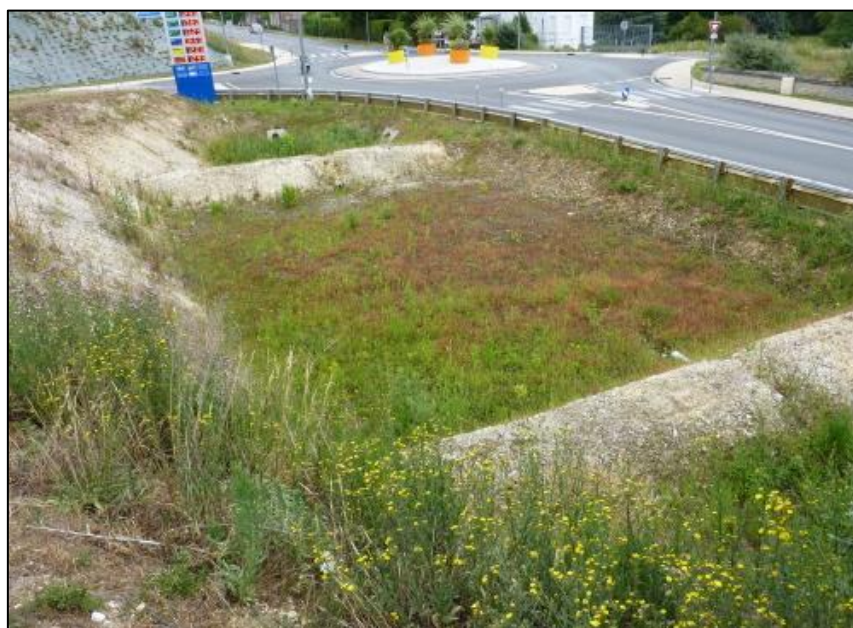
Figure 52. Photo du bassin 6
