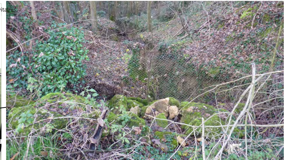
Les ruissellements concentrés ont creusé le relief en amont de Magneval. Des enrochements permettent de limiter le risque.
