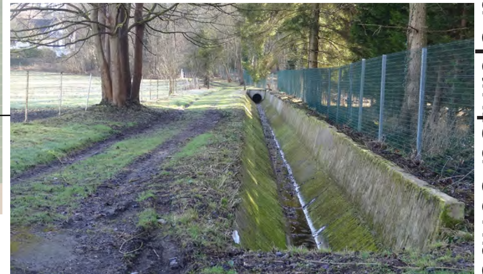
Fossé et buse le long de la prairie et du cheminement entre la rue Robert Ruegg et le chemin des Dîmes.
