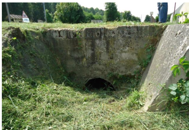
Figure 13. Sortie de la chambre à sable
