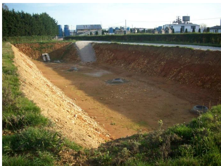
Figure 32. Exemple de bassin d'infiltration réalisé par Verdi Ingénierie Seine
