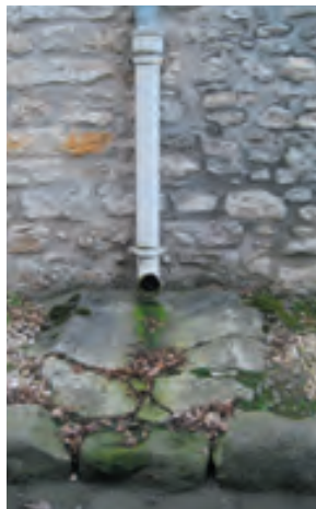
Dauphin rejetant les eaux de toiture vers une cunette puis vers le caniveau.
