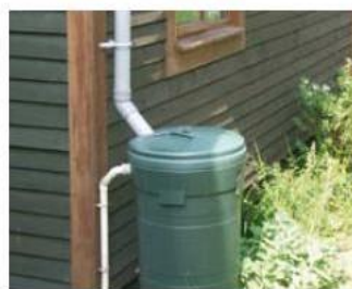
Collecteur d'eau de pluie sur gouttière
