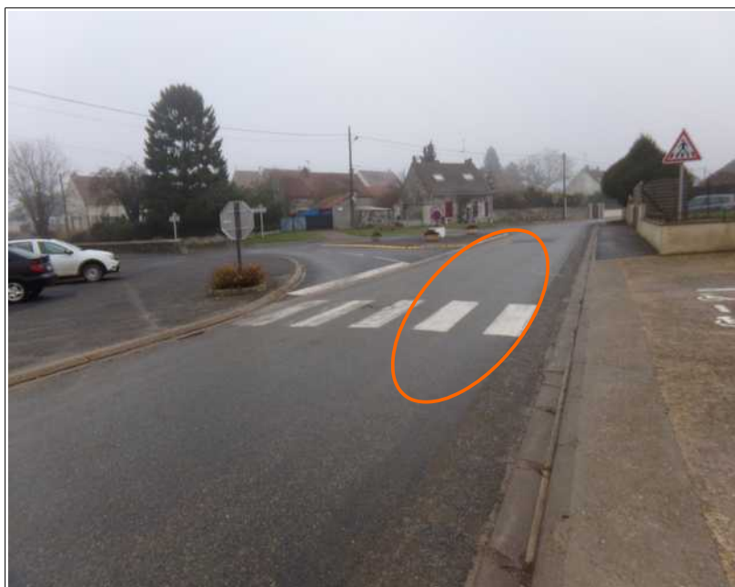
Figure III.10: zone d'affaissement face à la salle des fêtes (RD548).
