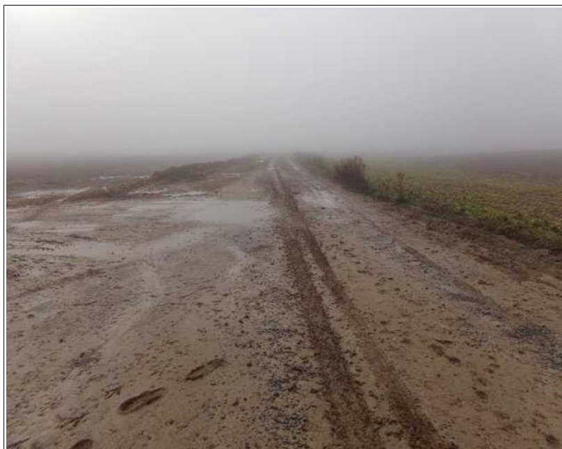
Figure III.9: exemple de dépôt boueux par des ruissellements sur un chemin d'exploitation du lieu-dit Les Buttes.
