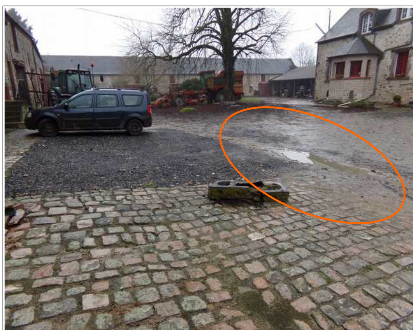
Figure III.11: zone d'affaissement dans la cour de la ferme de la route de Brégy, au niveau d'un axe d'écoulement superficiel.
