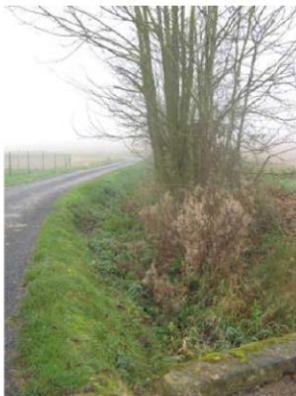
Photo 242, A remarquer l'approfondissement du lit sans utilité hydraulique Photo 125, Vue sur la partie amont du ru.
