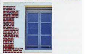
ravalement de mur de brique, joints à la chaux avec un appareillage panerresse/boutisse, occultation par un store intégré
