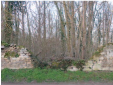
Un mur laissé en l'état après effondrement
