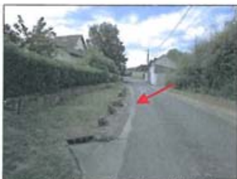
Puits d'infiltration dans la rue de l'Eglise
