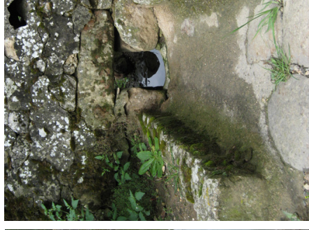
Petit dispositif de recueil et d'écoulement des eaux de pluie.
