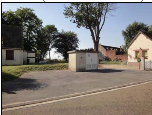
7- Transformateur + terrain libre (accès rue de Ménévillers)
