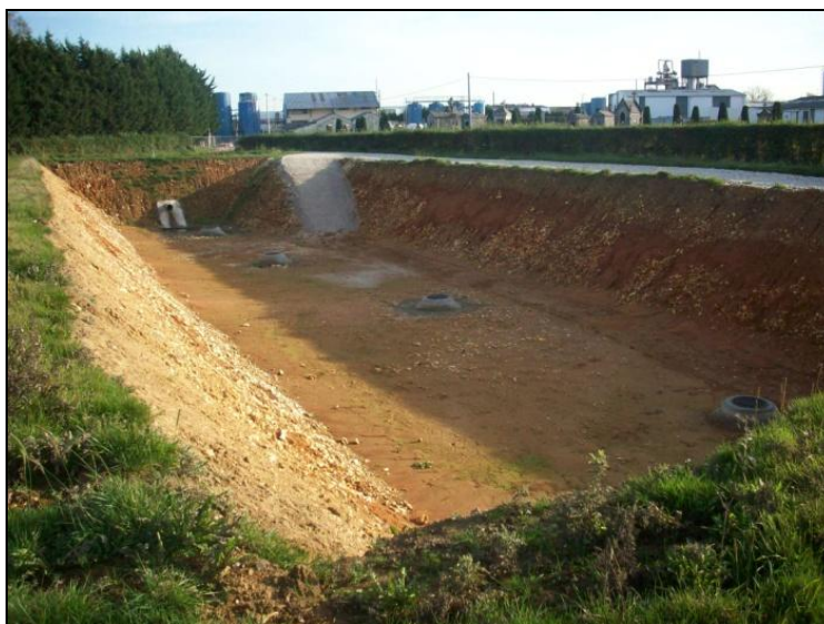
Figure 33. Exemple de bassin d'infiltration réalisé par Verdi Ingénierie Seine
