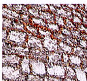
Joints en concaves
