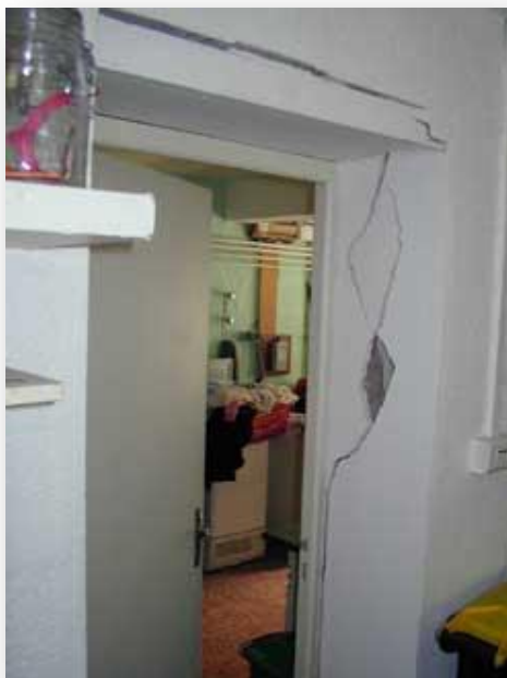
Figure 18 : Dégâts engendrés par le phénomène de retrait-gonflement des argiles
