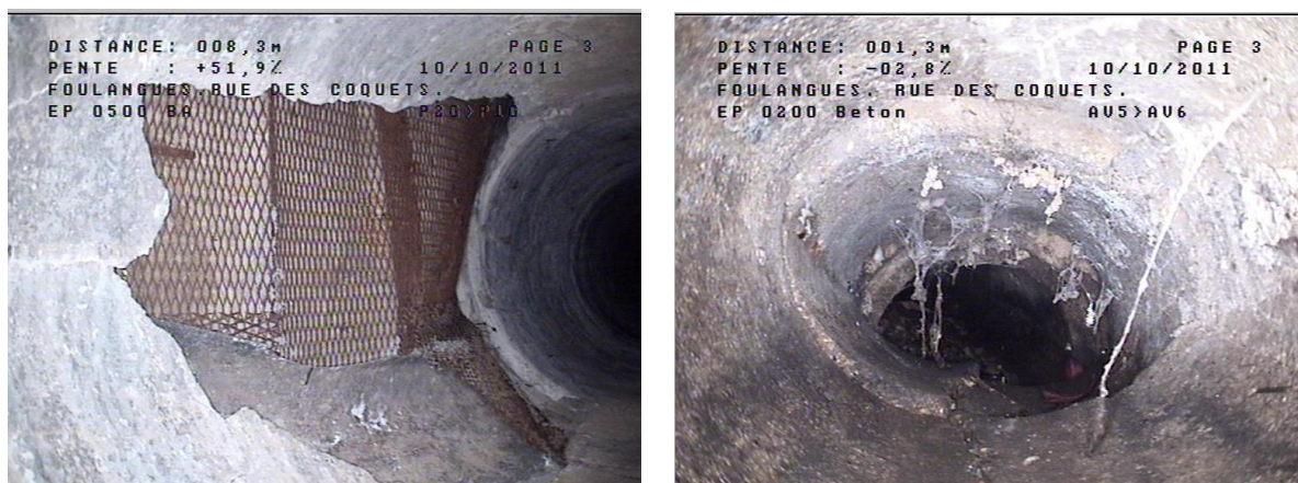
Figure 34. Anomalies mises en évidence au niveau de la rue des Coquets (Réparation et effondrement)
