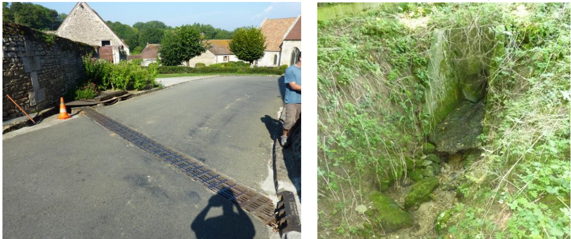
Figure 14. Caniveau grille captant le ruissellement de la rue de Cires Lès Mello et exutoire du tronçon
