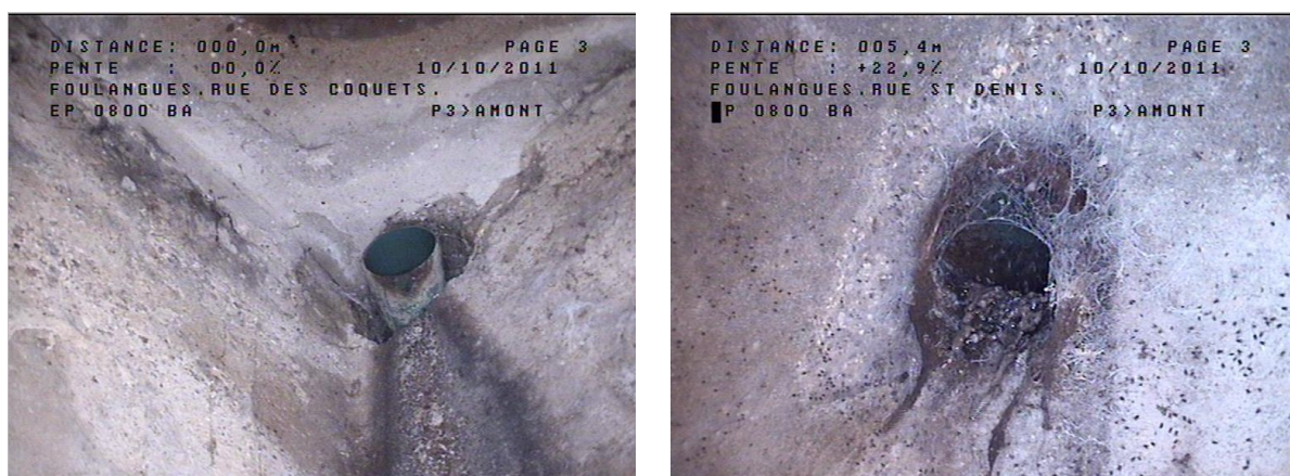
Figure 35. Anomalies mises en évidence au niveau de la Saint Denis (branchements d'eaux usées)
