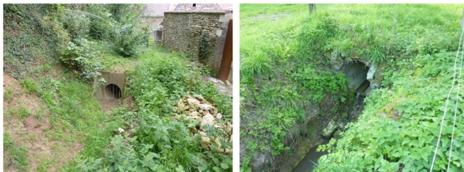
Entrée des eaux de ruissellement du chemin du Tour de Ville et son exutoire
