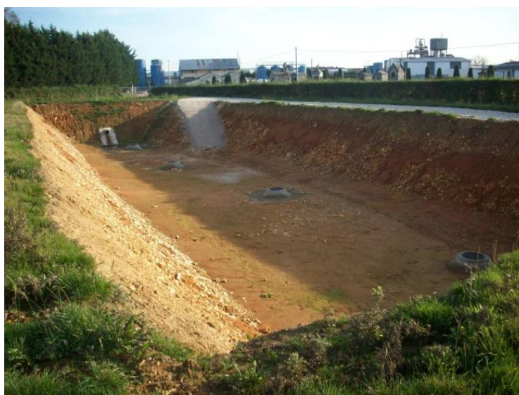
Figure 9. Exemple de bassin d'infiltration réalisé par Verdi Ingénierie Seine
