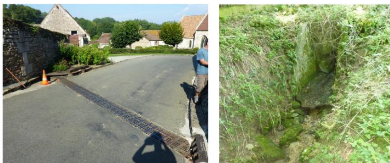
Caniveau grille captant les eaux de la Route de Cires et exutoire du tronçon
