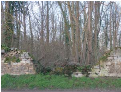
Un mur laissé en l'état après effondrement
