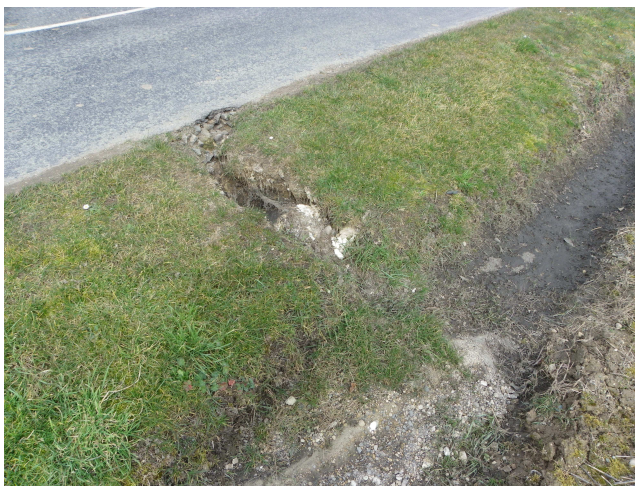
Figure n°14 : Détérioration de chaussée et engravement des fossés (Source : Alp'Géorisques)
