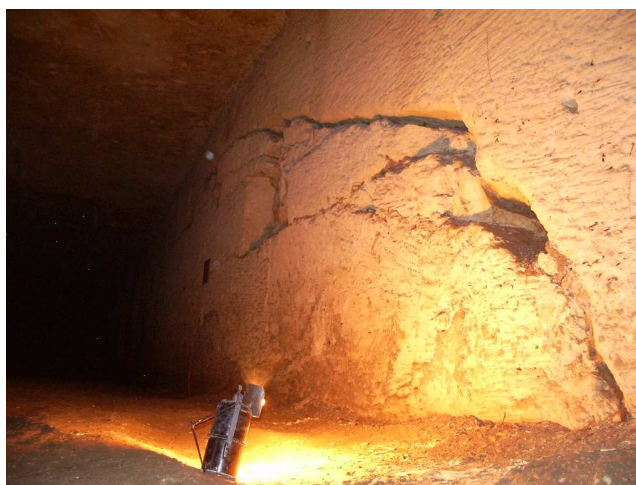
Figure n°23 : Fracture en anse de panier, carrière du chemin de Vez (Source : Guy Launay)
