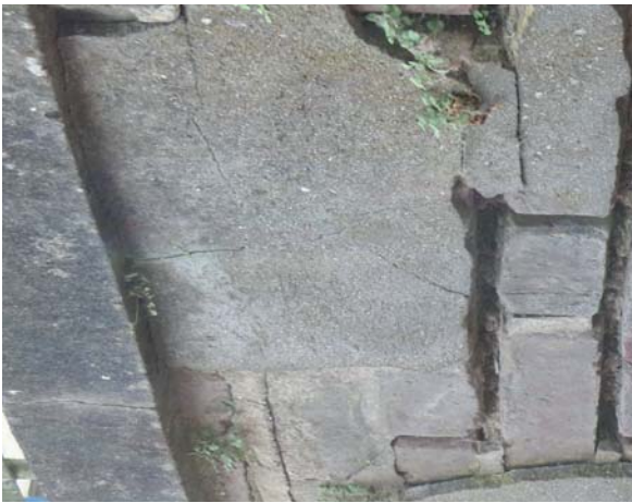
L'humidité s'accumule à l'arrière de l'enduit ciment appliqué sur un mur en brique ou en pierre. Les joints s'effritent et l'enduit se détache très rapidement
