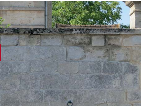
Ce mur en pierre de taille a été réalisé avec un calcaire tendre et gélif. La pierre s'effrite et se dégrade (alvéolisation et desquamation)
