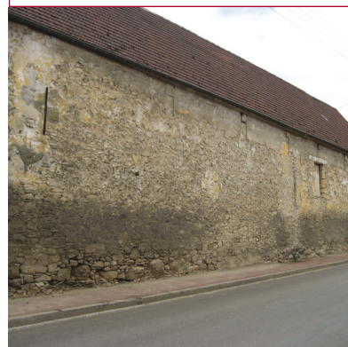
La maçonnerie souffre d'une humidité constante au niveau du soubassement, renforcée par l'imperméabilisation du trottoir et de la voirie.
