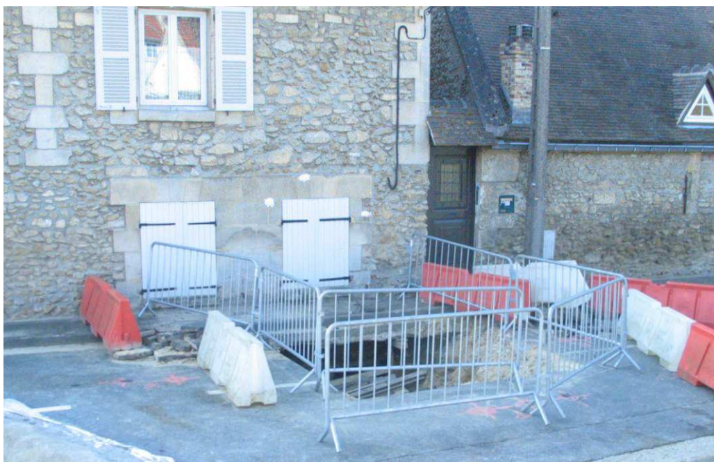
Photo 1 : Exemple de l'effondrement d'une cave voûtée à cheval sous l'habitation et la route dans un village du département de l'Oise.
