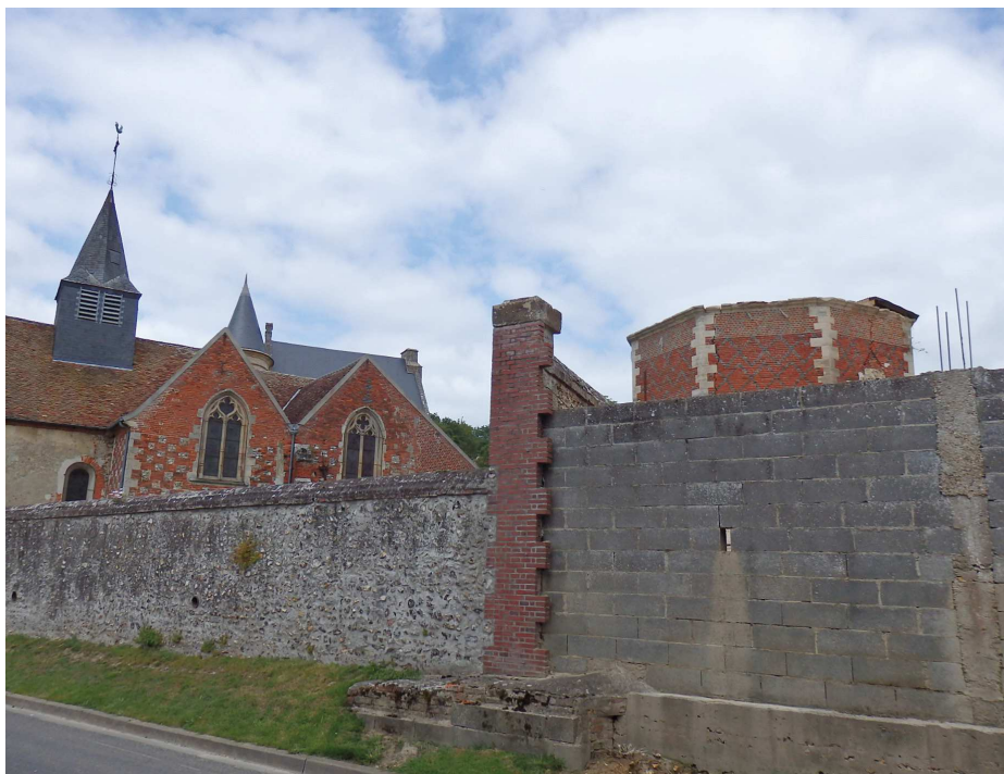
Eglise, murs en brique et pierres avec reprise en parpaings et colombier octogonal en briques et pierres rue de la Mairie.
