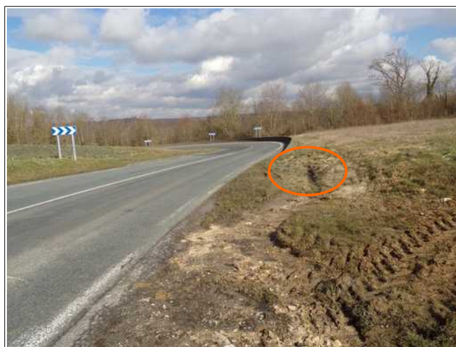
Figure III.3: RD332 au sommet du versant du village et passage d'eau obstrué.
