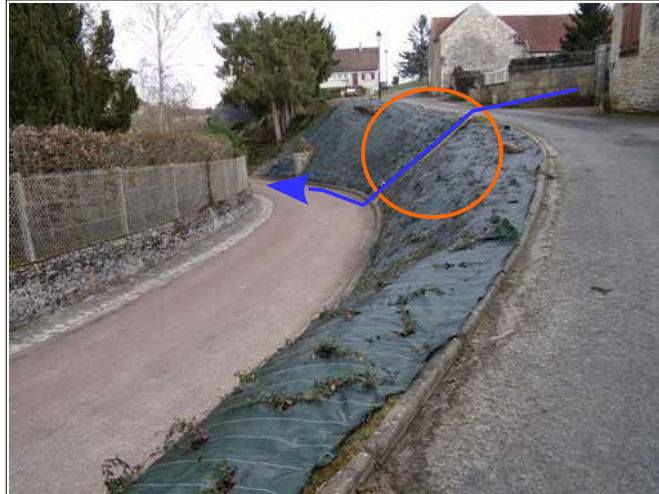
Figure III.6: les écoulements rejoignent la rue de l'Orme-Mon-Conseil. Le talus de la rue a été rétabli suite à l'inondation des années 1990 (toile de paillage et passage d'eau aménagé).
