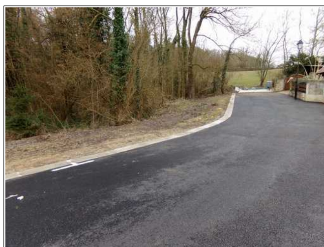
Figure III.14: débouché d'un talweg sur l'impasse aux Loups.
