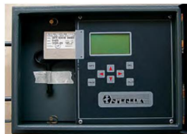
Système de comptages par tubes pneumatiques
