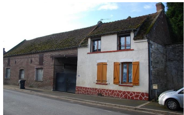
Figure 29: Traitement de façade dénaturant le caractère du bâti ancien, rue Marquenelle
