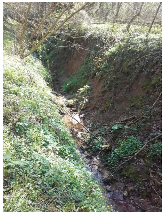
Erosion des berges du fossé bordant le chemin forestier
