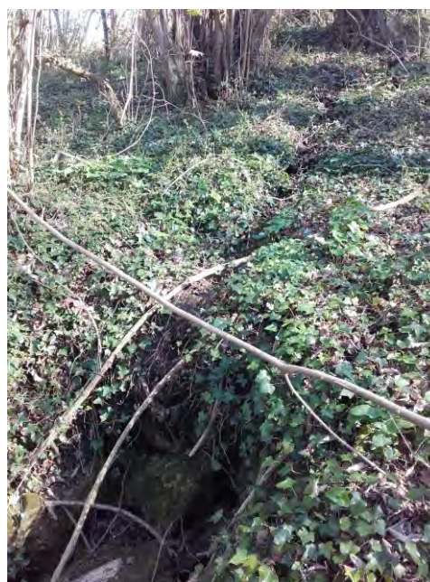
Béttoire recevant les eaux du réseau pluvial
