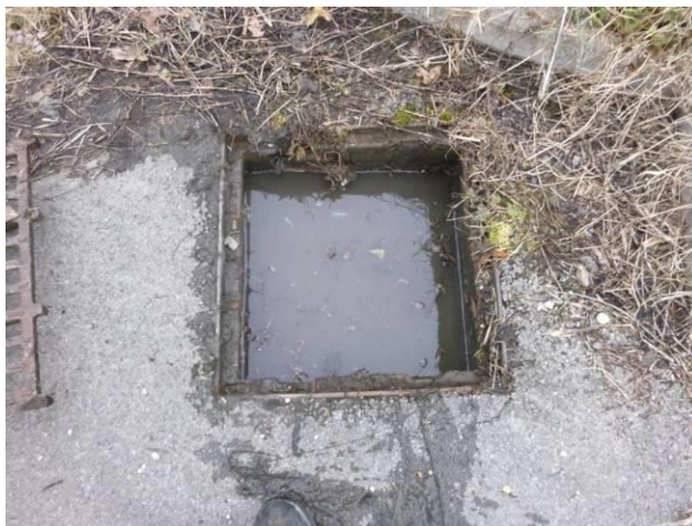
Figure 34. Grille en charge rue du Pont
