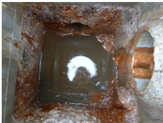
Figure 33. Traces de rouilles rue de l'Aune
