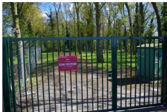
Un des nombreux captages présent sur la commune
