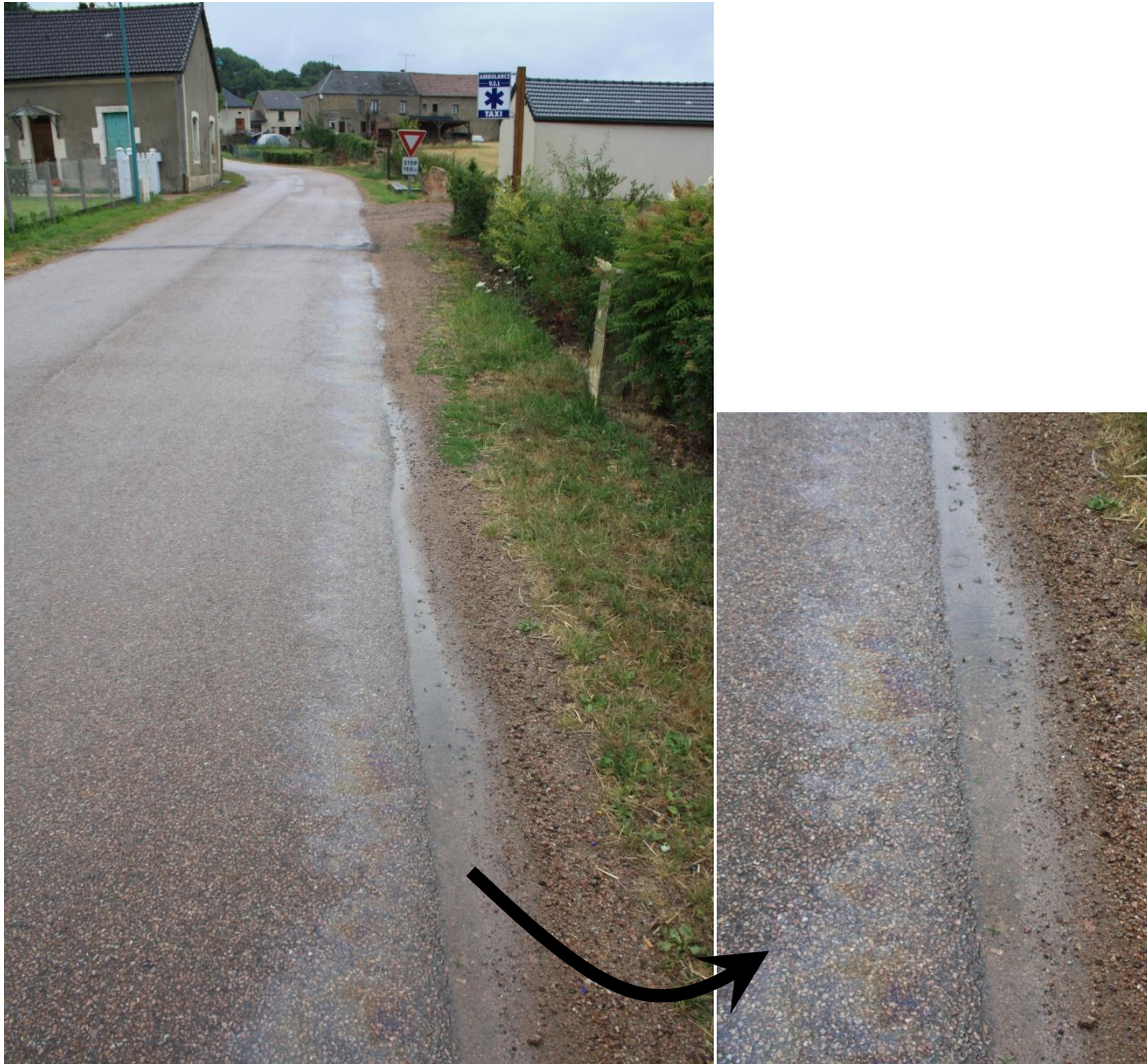
Photographie 23 : Traces d'hydrocarbures en bordure de chaussée
