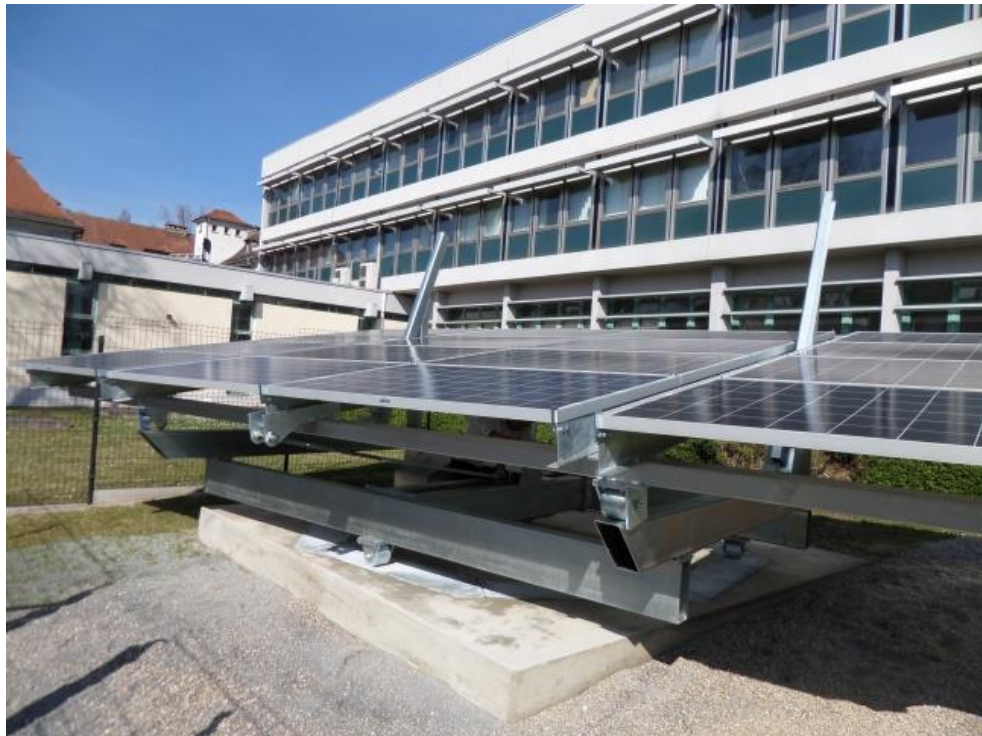
Tracker solaire (installation photovoltaïque)
