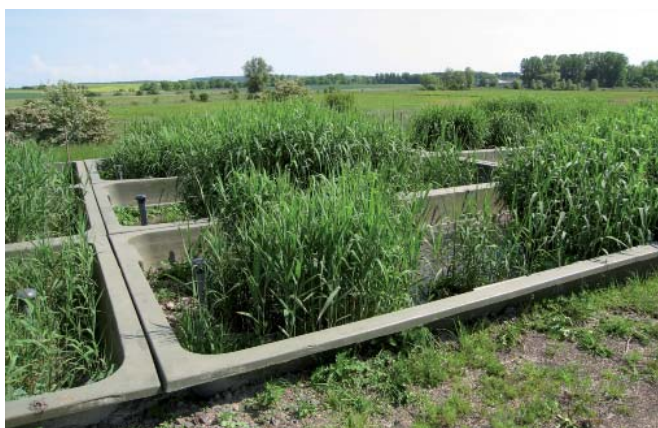
Lagune d'assainissement à bacs
