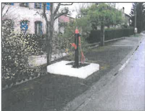
Poteau incendie à SAINT EPVRE
