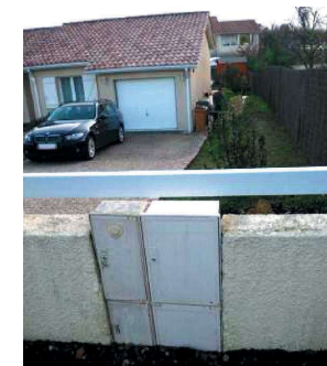
Figure 16 Situation classique d'une maison construite en contrebas du compteur électrique de la route d'accès (Source Socabat)
