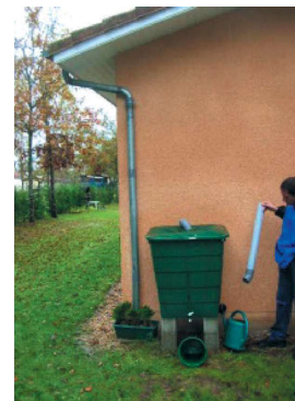
Figure 7. Réservoir de collecte des eaux pluviales non équipé d'un « trop-plein » raccordé au réseau d'évacuation. Le risque d'hydratation accidentelle du sol de la construction est certain (Source Socabat)
