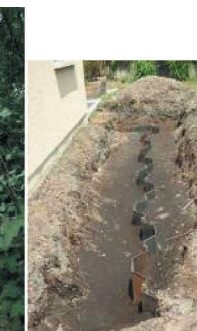
Figure 27 Écran métallique (Source Socabat)
