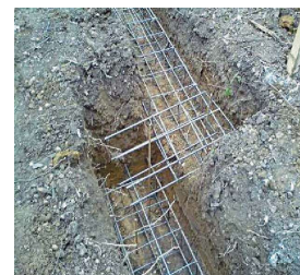
Figure 16 Mauvaise mise en place des ferrailages (défaut de recouvrement, de liens entre ferrailages, attente de liaisons des poteaux). (Source Socabat)
