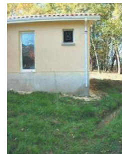
Figure 11 La descente d'eaux pluviales non raccordée concentre l'hydratation accidentelle dans l'angle. Les eaux ne sont pas évacuées du fait de l'absence d'un nivellement adapté et stagnent non loin de l'angle (Source Socabat)
