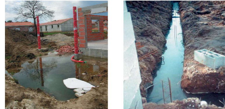
Figure 13 Défaut de gestion des eaux pluviales en phase de construction (Source Socabat)
