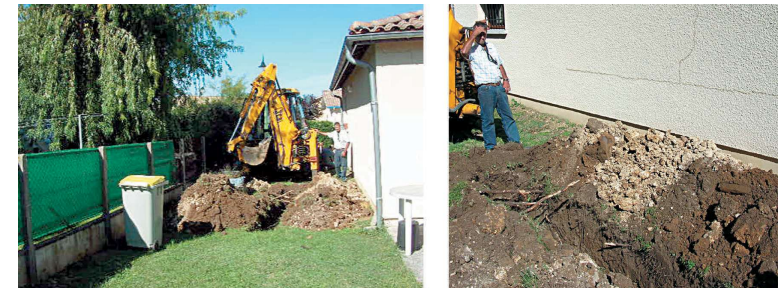
Figure 5 Exemple de pathologie (fissures) liées à la présence de racines sous la construction (vue d'ensemble à gauche et vue des racines et des fissures à droite) (Source Socabat)
