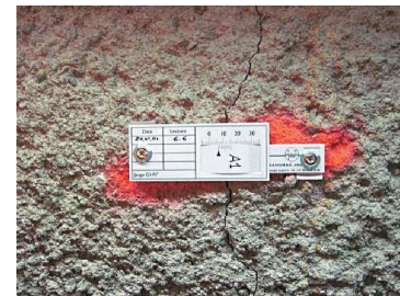
Figure 18 Exemple de jauge à vernier mesurant l'ouverture d'une fissure (Source Socabat)
