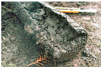
Figure 14 Drain colmaté et sol de fondation saturé propice au gonflement (Source Socabat)
