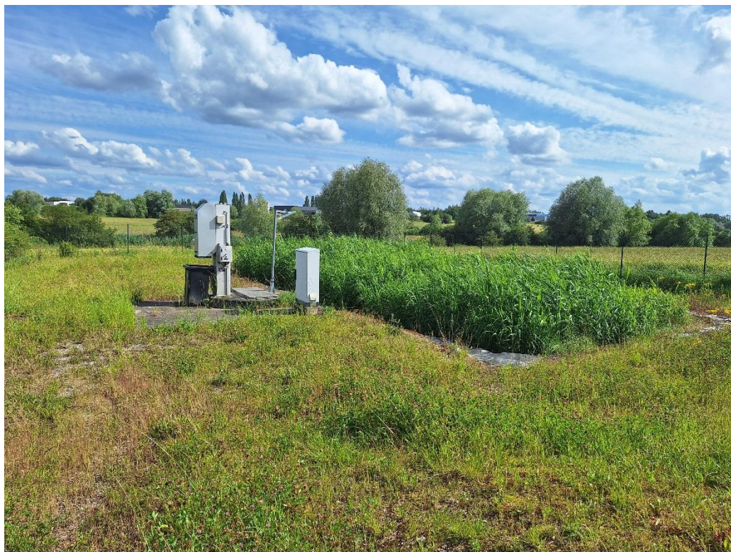
Station de traitement des eaux usées (ESTERR)
