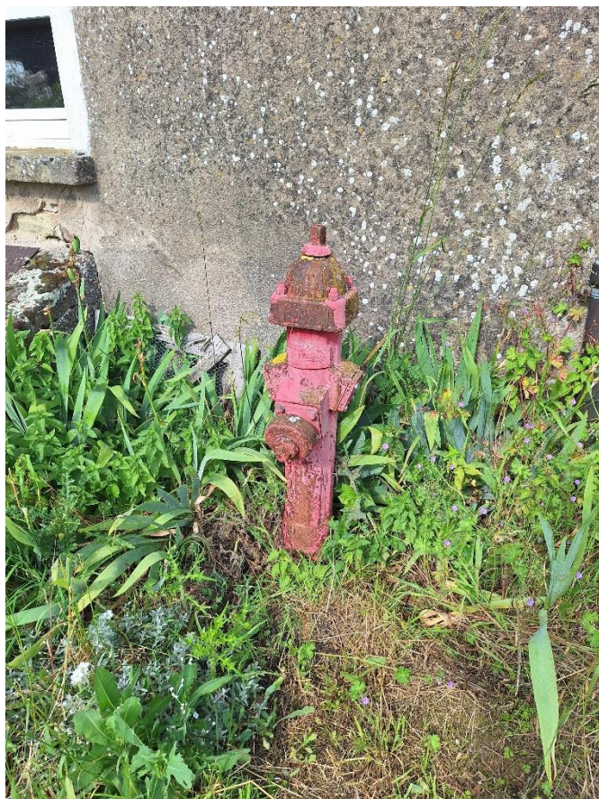
Poteau incendie (ESTERR)
