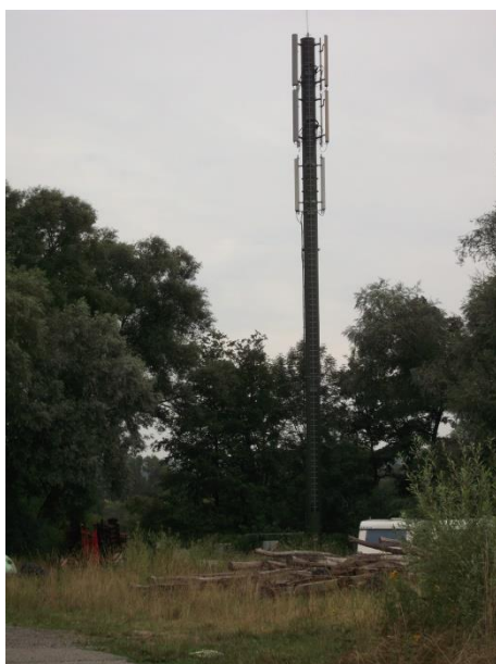
Antenne de téléphonie mobile de Blies-Guersviller
