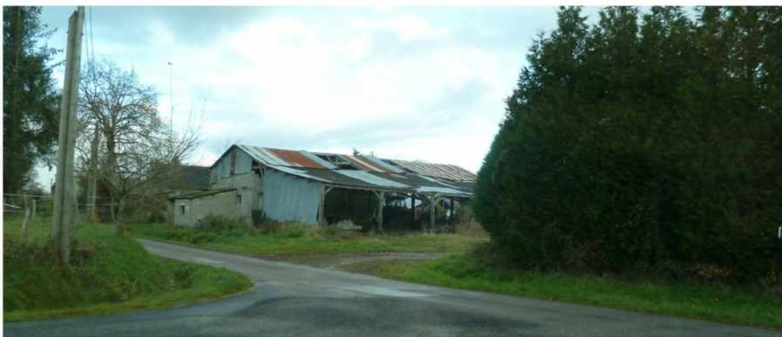
Bâtiments agricoles à l'abandon
