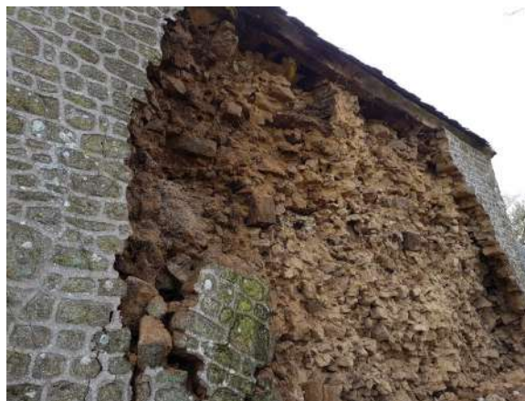
exemple de flambage, évolutif d'un bouffement de mur
