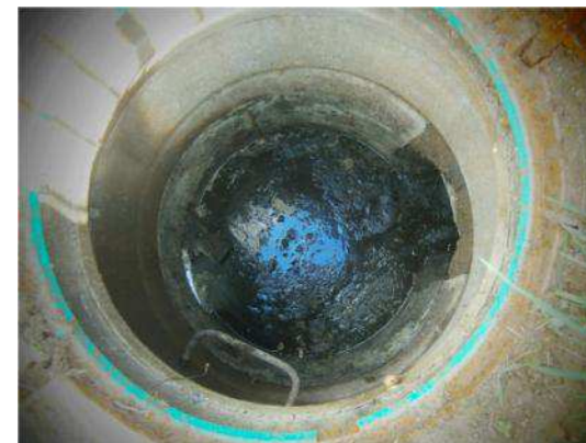
Photo 6 : Eaux Usées rue Hent Daou
