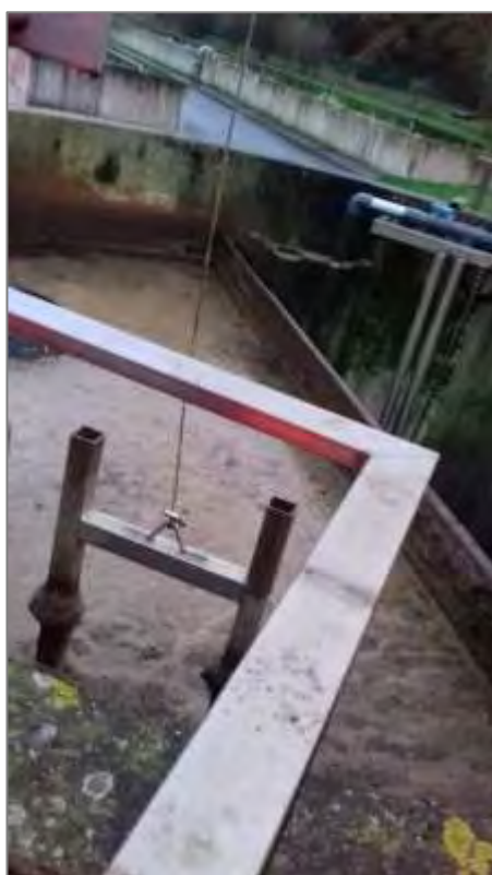
Absence de râclage du dégazeur (vanne fuyarde)
