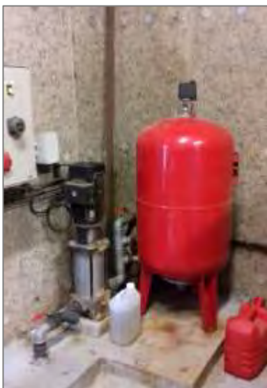
Groupe d'eau industriel dans le local surpresseur
