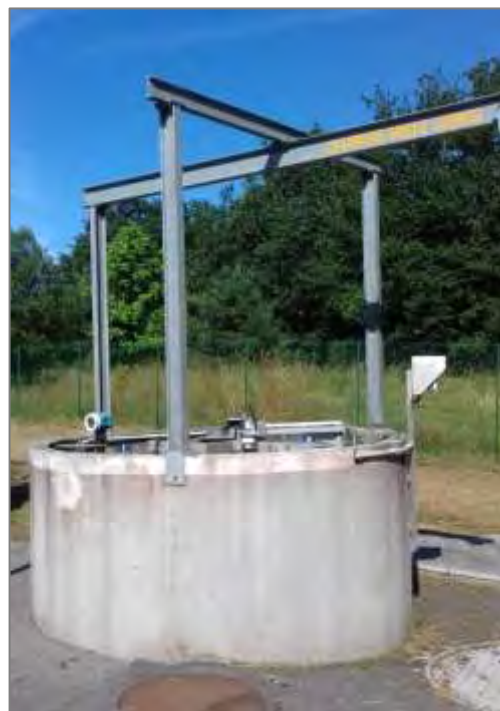
Poste de relèvement des effluents
