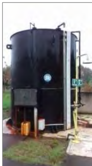
Stockage du chlorure ferrique
