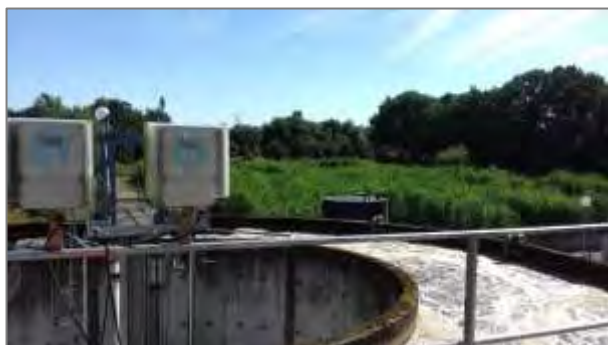
Bassin Tampon – Bassin d'aération
