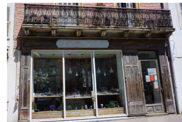
Les grandes baies vitrées dénaturent la composition d'origine : l'imposte et l'allège ont été supprimées.
