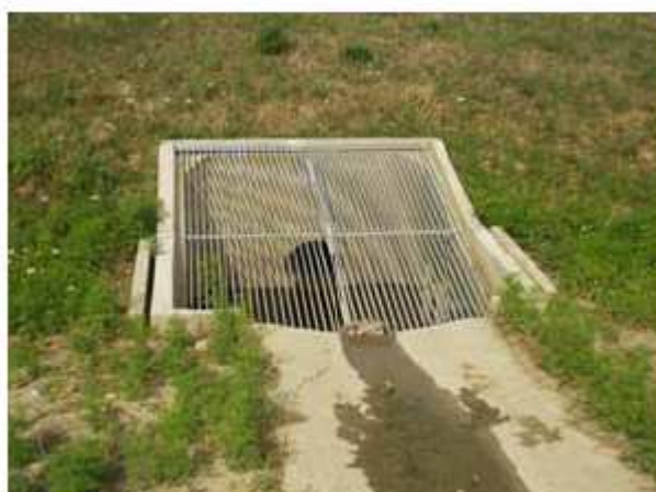
Grille de protection sur ouvrage de sortie
