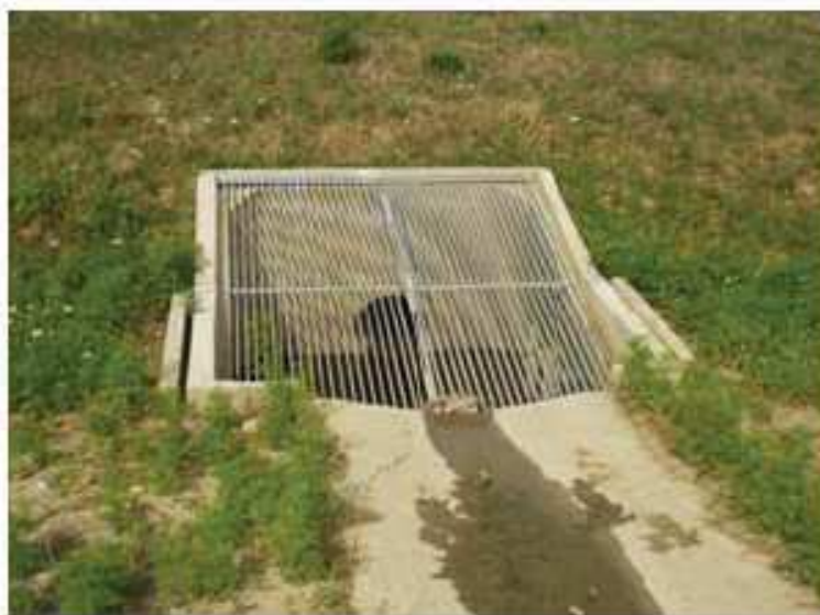
Grille de protection sur ouvrage de sortie
