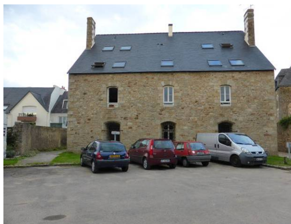
Rue du Jeu de Paume. Façade arrière de l'ancienne prison (18 e siècle). Ajouts de châssis de toit perturbant l'homogénéité initiale de la couverture.
