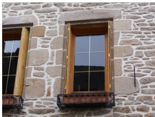
Rue du Château. Menuiserie à un grand carreau en bois divisé par des petits bois collés. L'anglet qui profile l'encadrement de pierre est masqué en partie par des contrevents pliant peu cohérents avec la qualité de l'ouverture
